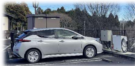
EV及び充放電器
