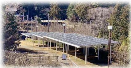
太陽光発電設備
